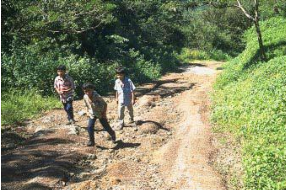
Figura 7: Exemplo de uma estrada com um sistema de drenagem ineficaz. (Keller et al. , 2003).
