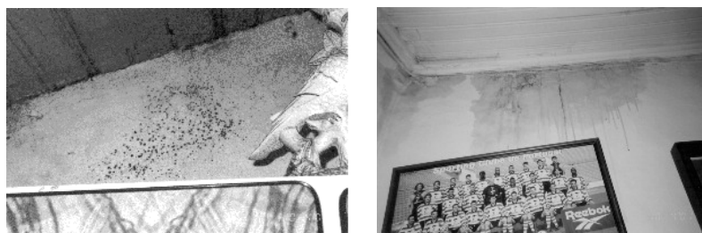
Figura 5: Registo fotográfico de algumas manifestações patológicas provocadas pela presença de humidade nos edifícios em estudo.
