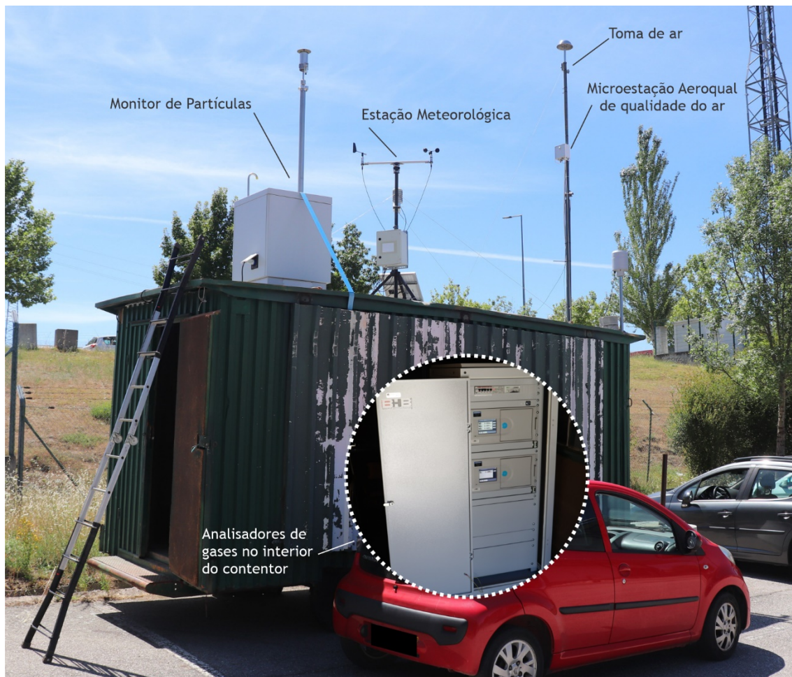
Fig. 36- Presentación de la estructura instalada para la monitorização de la cualidad del aire y parametros meteorológicos. En la imagem son identificados los principales componentes utilizados en el estudio.
