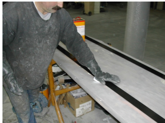
Figura 5.17 – Limpeza do laminado.
