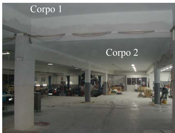
Figura 5.2 – Desnível entre “Corpo 1” e “Corpo 2”.
