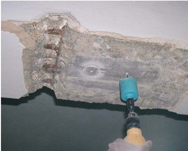
a) Pré-caroteamento na face inferior de vigas.
