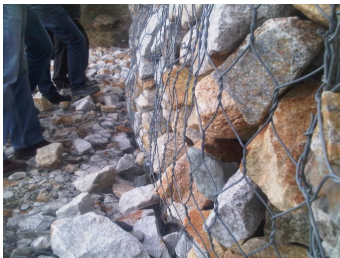
Figura 13 – Deformação das caixas na base do muro
