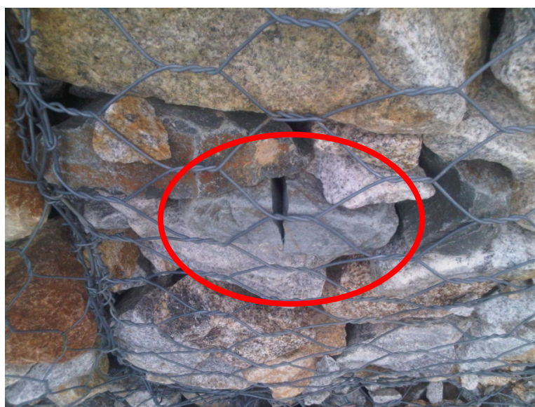
Figura 14 – Rotura dos inertes no interior das caixas
