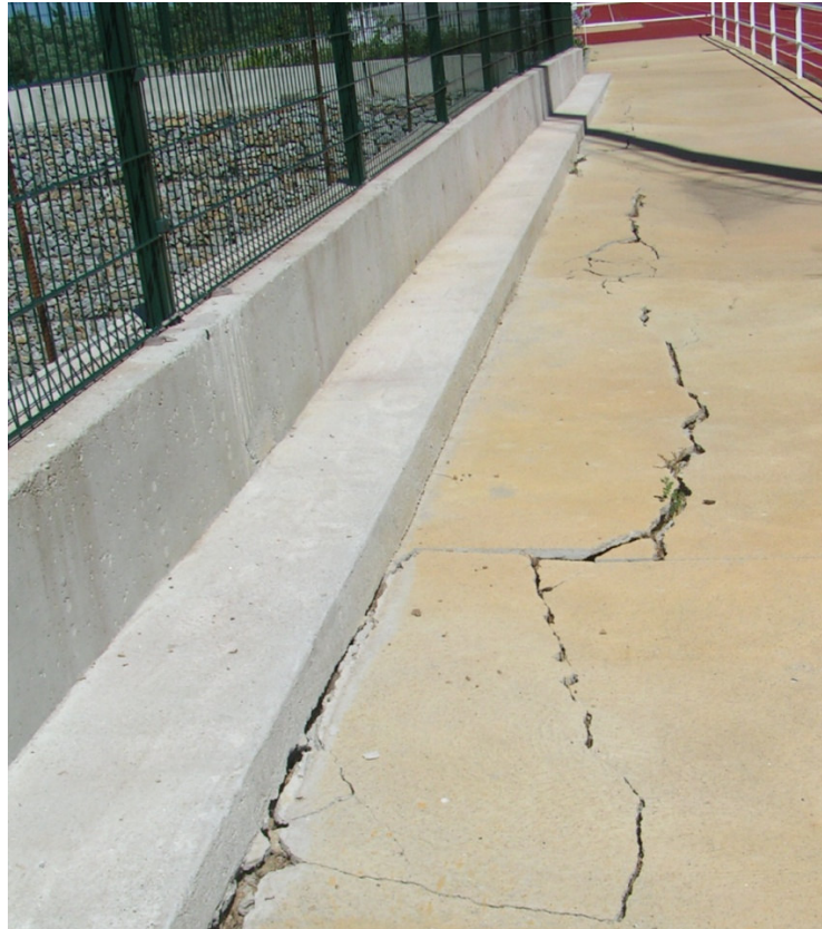
Figura 6 – Rotura dos passeios no tardo do muro
