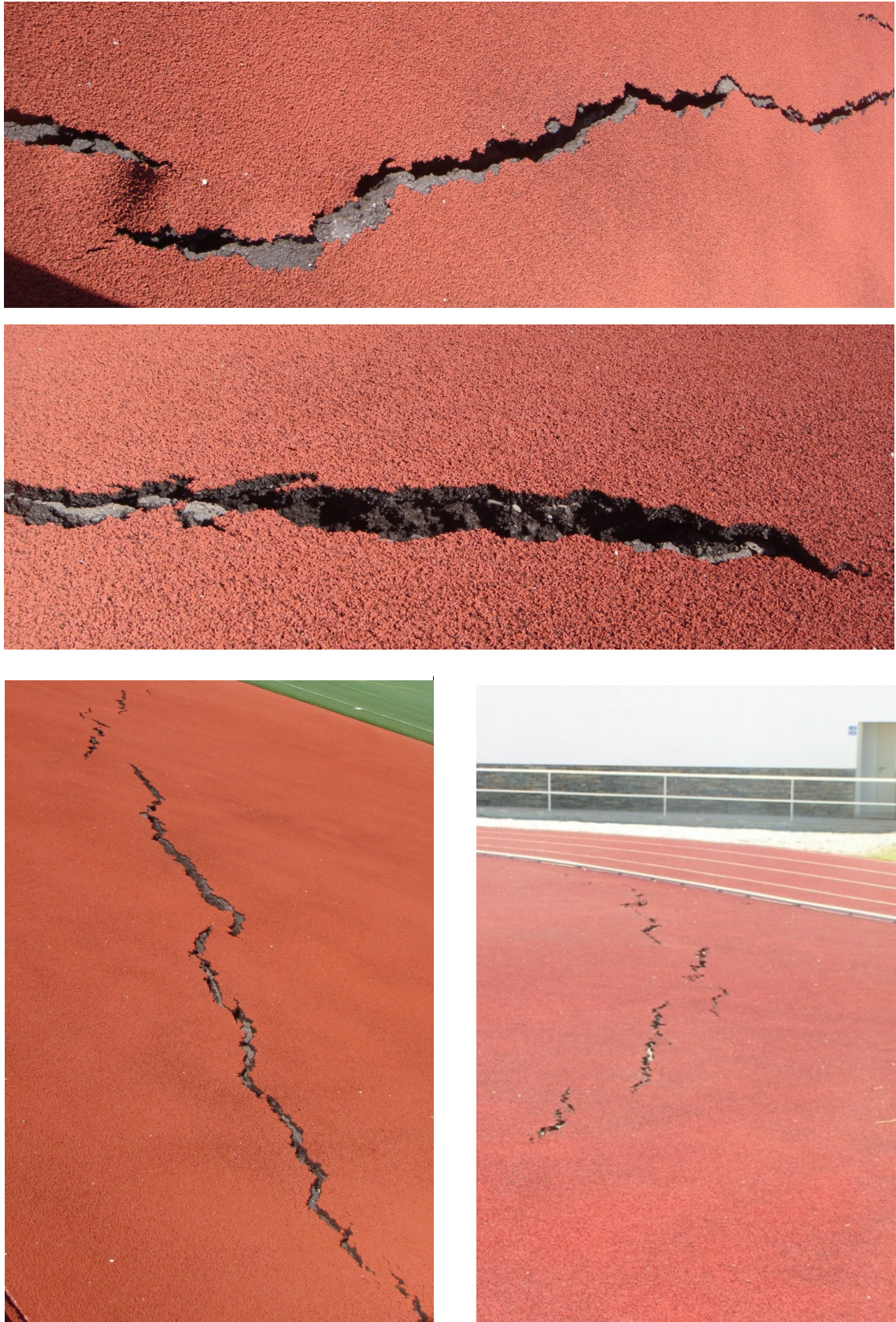
Figura 5 – Fissuração do pavimento da pista de atletismo.
