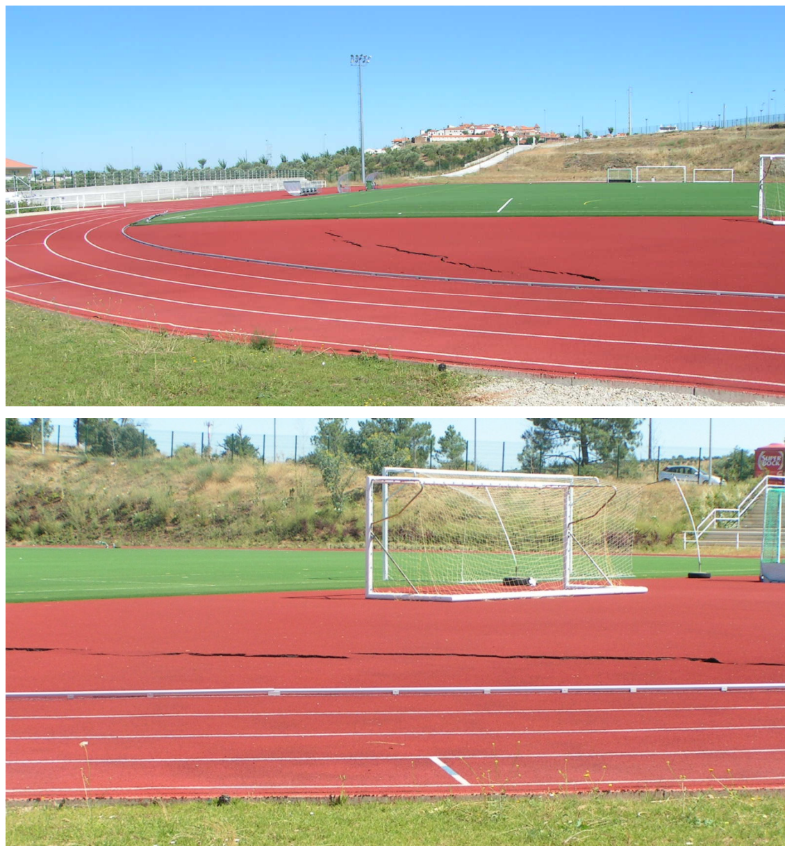
Figura 4 – Fissuração do pavimento da pista de atletismo – Zona 4.
