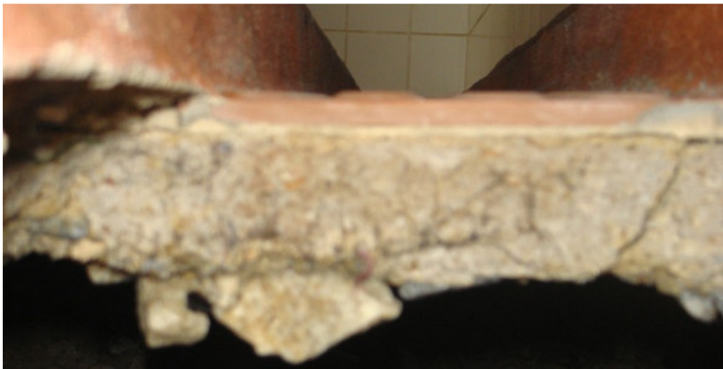
Figura 9 - Assentamento do pavimento do balneários
