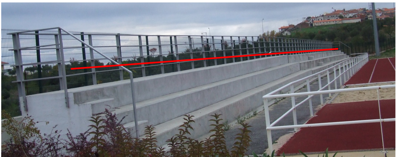
Figura 11 – Assentamento diferencial da bancada
