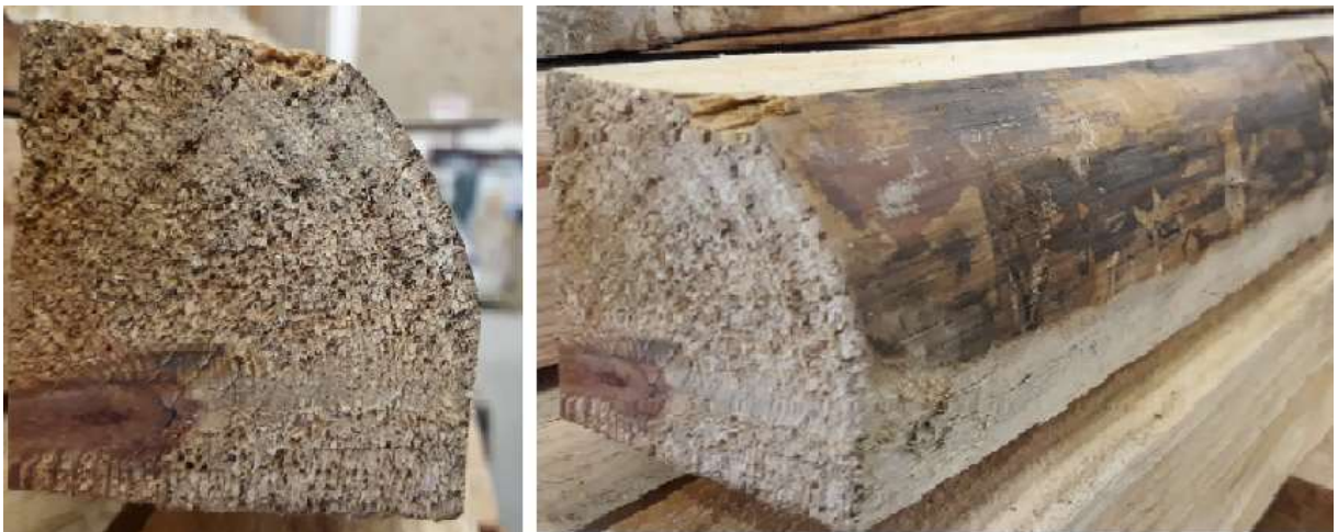
Figura 16 – Descaio e presença de casca do toro no elemento de madeira.
