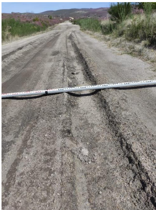
Figura 15 - Exemplo de afundamento presente na EBVT não pavimentada de Montesinho em 2023
