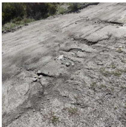
Figura 20 - Erosão transversal na EBVT não pavimentada de Montesinho em 2023
