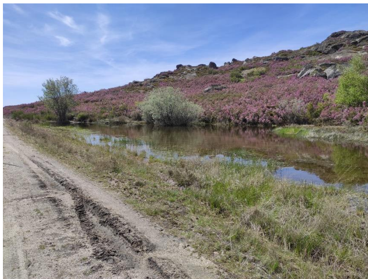
Figura 22 - Água acumulada ao lado da EBVT não pavimentada de Montesinho em 2023
