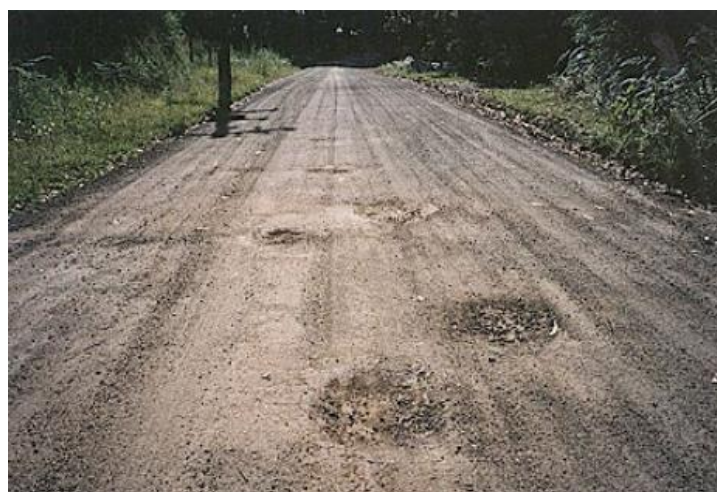
Figura 17 - Fotografia de uma estrada não pavimentada com presença de buracos em sua superfície Fonte: ARRB, 2009.
