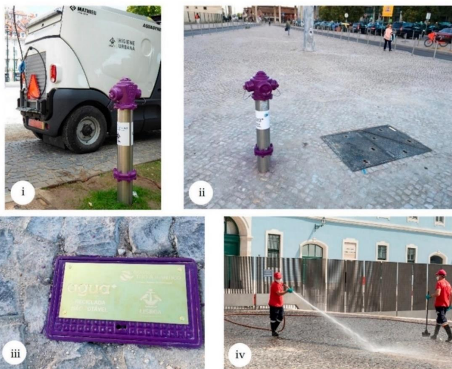
Figura 2.5. Rede de hidrantes de reutilização de água na baixa de Lisboa: Primeiras bocas de reutilização de água instaladas na zona baixa de Lisboa (i ,ii); Boca de incêndio subterrânea de reutilização de água na baixa de Lisboa (iii); Pessoal de higiene urbana a lavar uma rua com águas residuais tratadas na baixa de Lisboa (iv). Disponível em: < https://doi.org/10.3390/su151612578 >. Acesso em: 19 de fevereiro de 2024.
