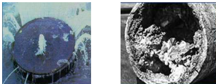
Figura 1.13 - Resultados da deposição de óleos nas condutas de esgotos. [26]
