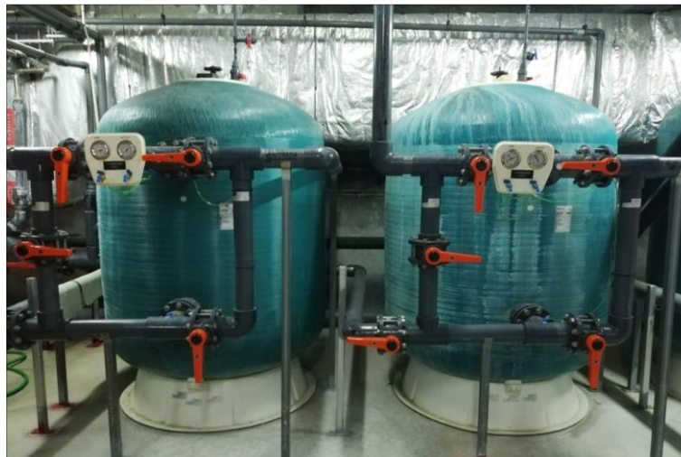
Figura 23: Conjunto de filtros da piscina de aprendizagem.
