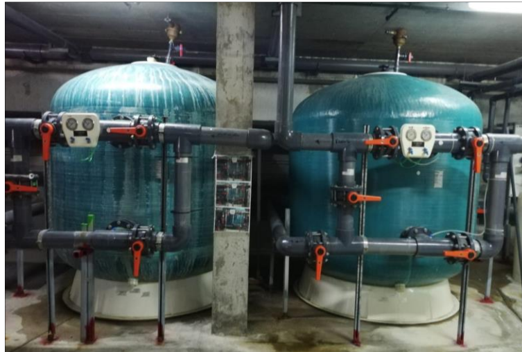
Figura 22: Conjunto de filtros da piscina de competição.
