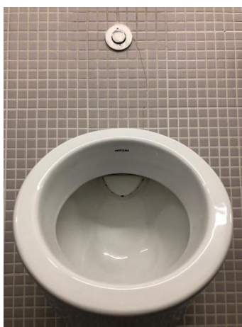
Figura 3.6: Medição do volume de descarga dos urinóis.
