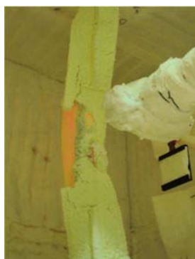
Figura V.239 – Zona de desprendimento da camada intumescente.
