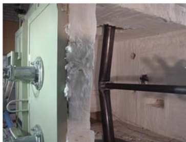
Figura V.155 – Vista no topo do elemento deformado.
