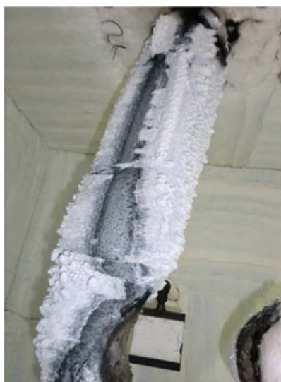
Figura V.165 – Zona do elemento exposta ao fogo, devido à retracção da camada intumescente.
