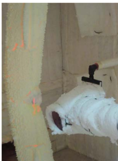
Figura V.225 – Pormenor da zona de instabilização lateral no elemento.
