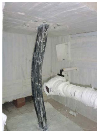
Figura V.231 – Deformação implantada ao elemento, depois da sua ruptura.
