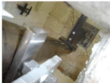
Figura V.152 – Vista no topo do elemento deformado.
