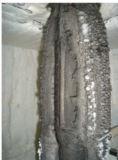
Figura V.184 – Visualização da retracção da camada, que expôs o aço às altas temperaturas.
