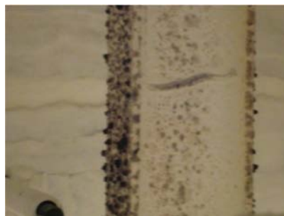
Figura V.95 – Início da Reacção da protecção.
