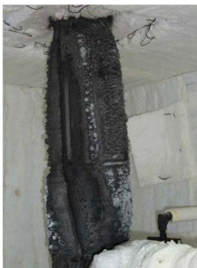
Figura V.175 – Visualização da retracção da camada, expondo o aço às altas temperaturas.
