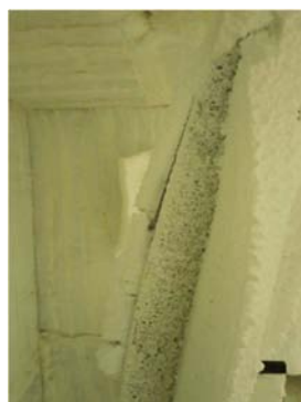
Figura V.240 – Zona do elemento que ficou exposta pela retracção da tinta.
