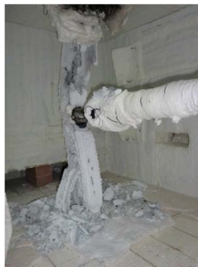
Figura V.105 – Desprendimento da camada intumescente.
