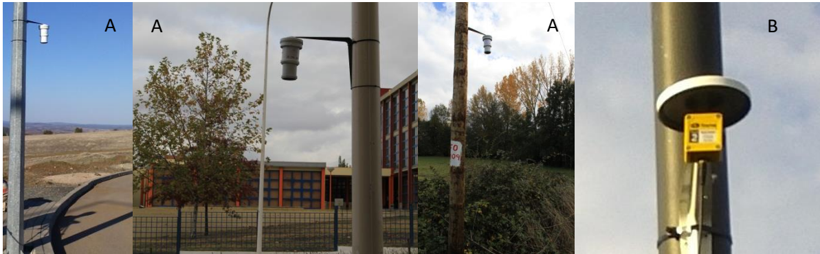
Figura 14 - Locales con monitorización de la temperatura y humedad relativa (A); detalle del sistema de medición sin el abrigo (B)
