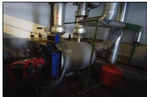
Figura 18. Produção de energia elétrica/térmica em Motogerador
