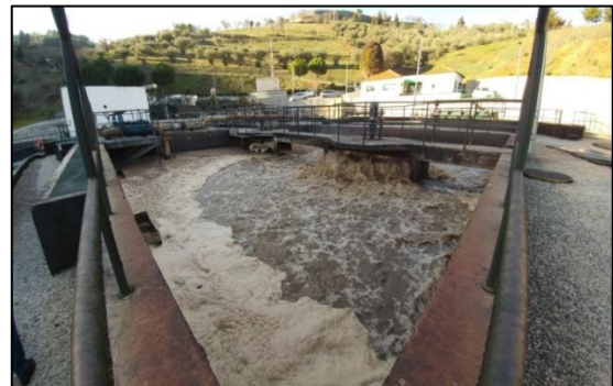
Figura 13. Tanque de arejamento por turbina
