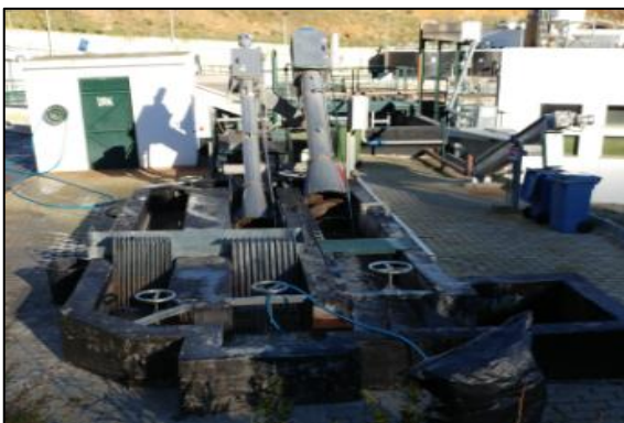
Figura 10. Sistema de gradagem e tamisação
