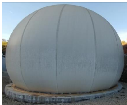
Figura 17. Armazenamento do biogás em Gasómetro
