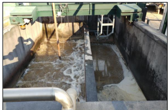
Figura 11. Desarenador e separador de gorduras
