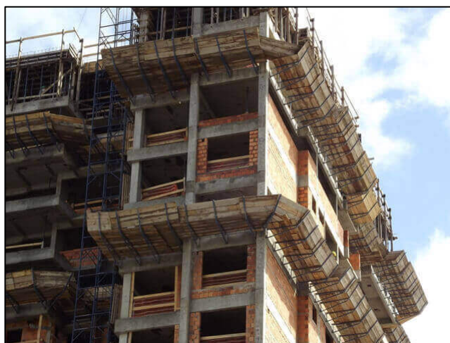
Figura 10 - Plataformas de Proteção em Altura.
