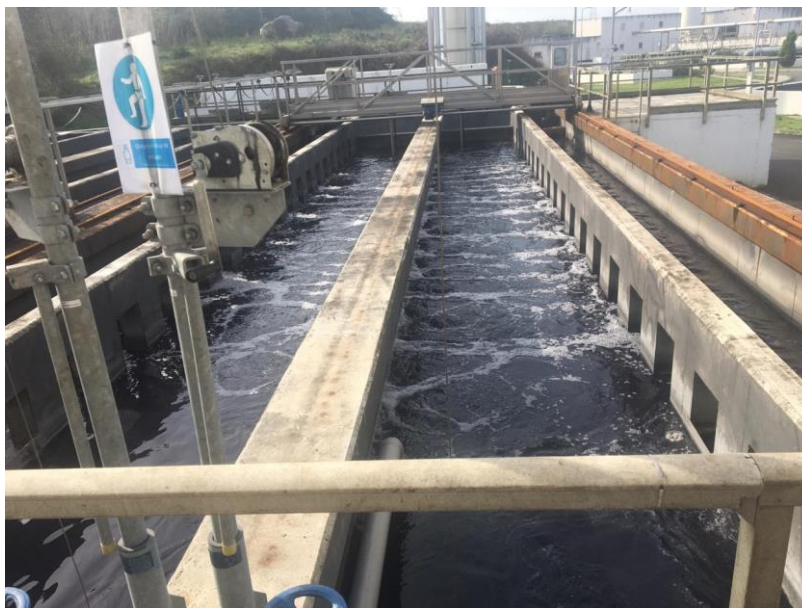
Figura 20 – Tanque de desarenamento e desengorduramento.
