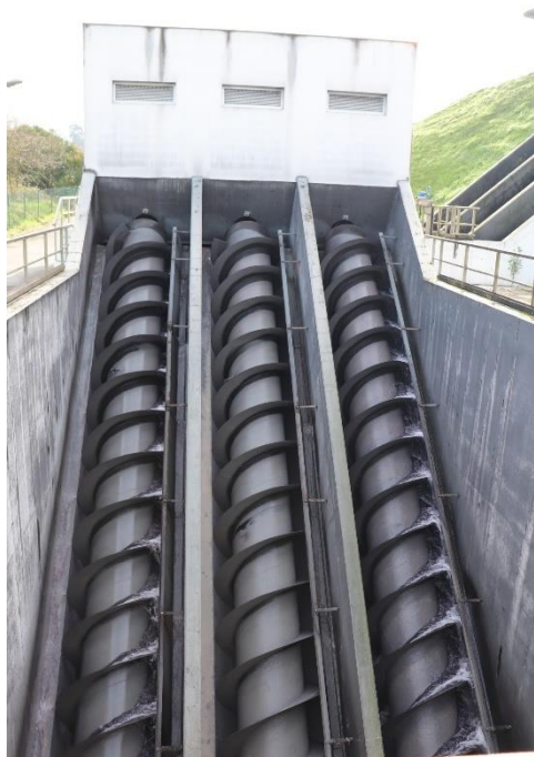
Figura 17 – Estação elevatória (Estágio 1) constituída por três parafusos de Arquimedes.
