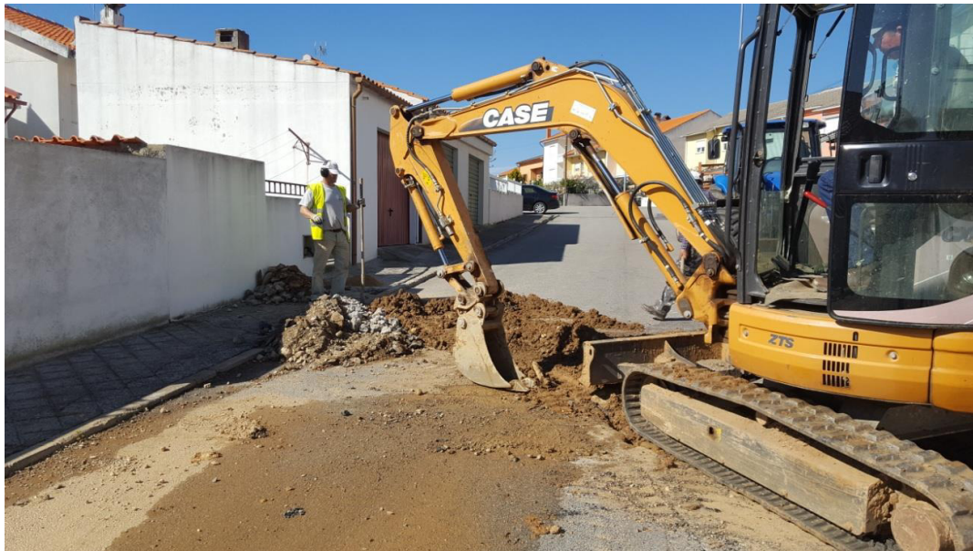
Figura 5 - Reparação de ramal de abastecimento de água em Alfândega da Fé. Fonte: própria, 2017
