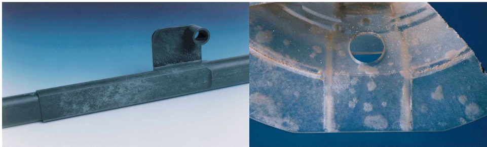
Figura 38 – Podemos verificar manchas brancas de vários formatos.
