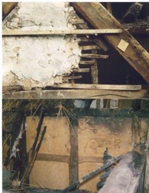
Figura 3 - Parede de tabique após exposição ao fogo [11].
