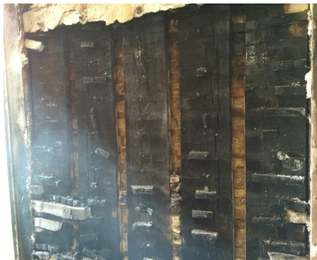
Figura 47 – Resultado da Parede I após o ensaio.
