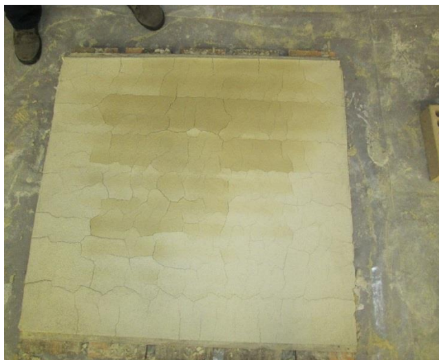
Figura 16 – Fissuração da parede após 3 dias de secagem.
