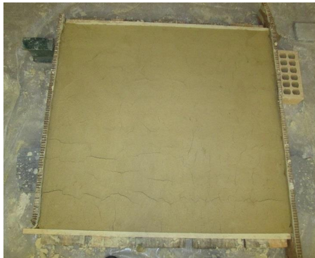
Figura 15 – Fissuração após 1 dia de aplicação da mistura argilosa.
