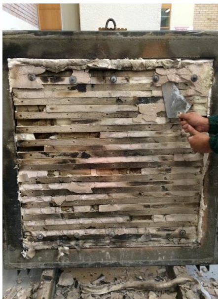
Figura 49 – Estrutura de madeira da Parede II após o ensaio.
