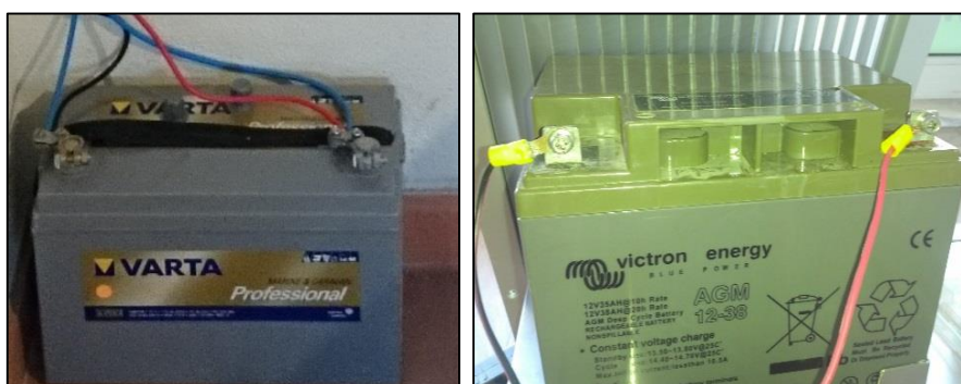
Figura 12 - Exemplo de baterias utilizada pela empresa.
