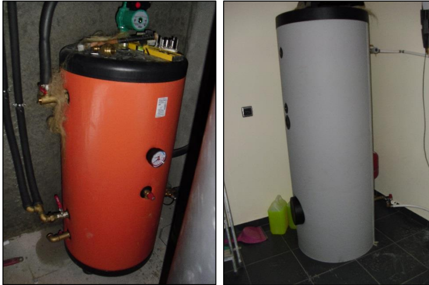
Figura 27 - Exemplo de acumuladores utilizados pela empresa.
