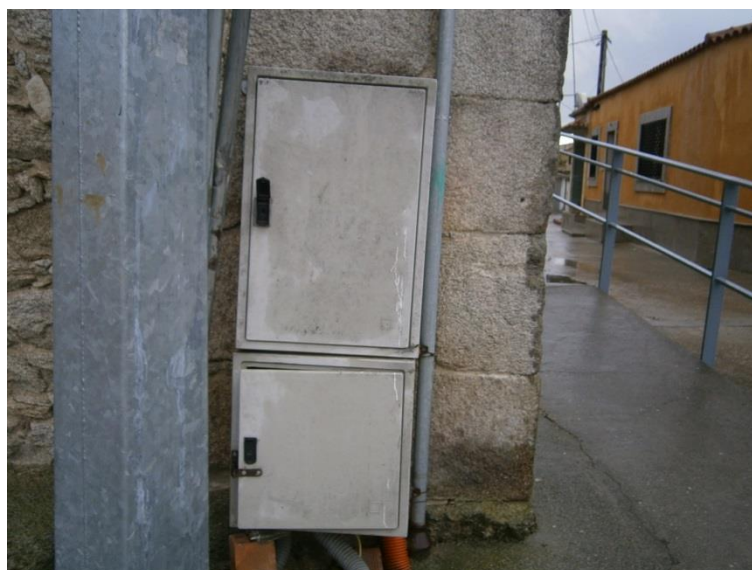
Fig. 5.10 - Quadro elétrico sem nenhuma fechadura
