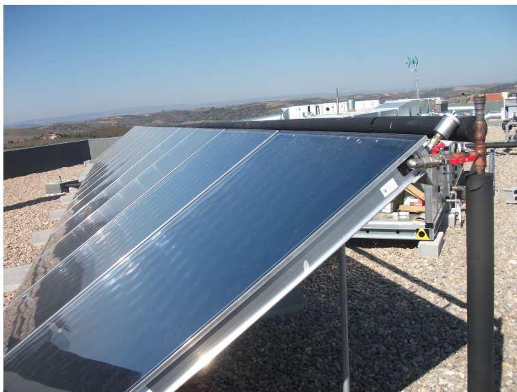
Figura 3.24: Sistema colectores solares
