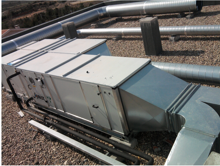
Figura 3.17: UTAN piso 1 y ductos
