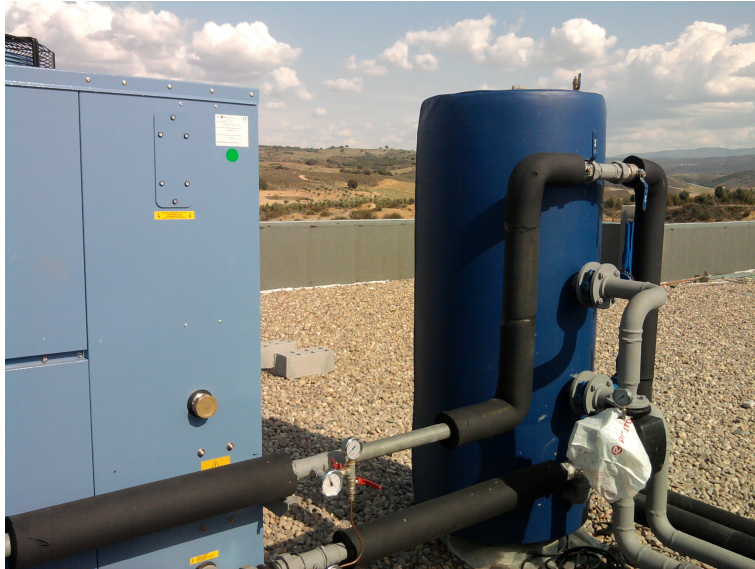
Figura 3.25: Bomba de calor y depósito acumulador
