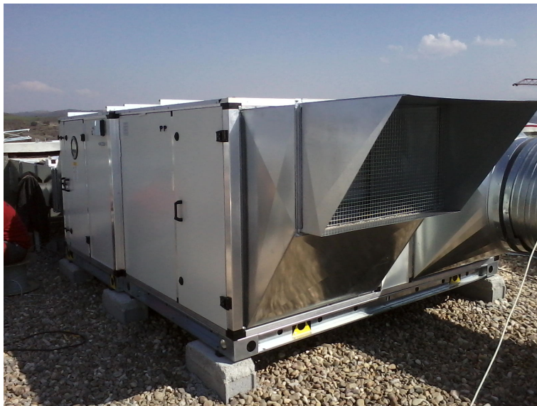
Figura 3.18: Entrada de aire nuevo en UTAN piso 0
