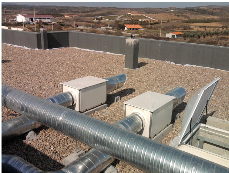
Figura 3.16: Ventiladores de extracción 1 y 2
