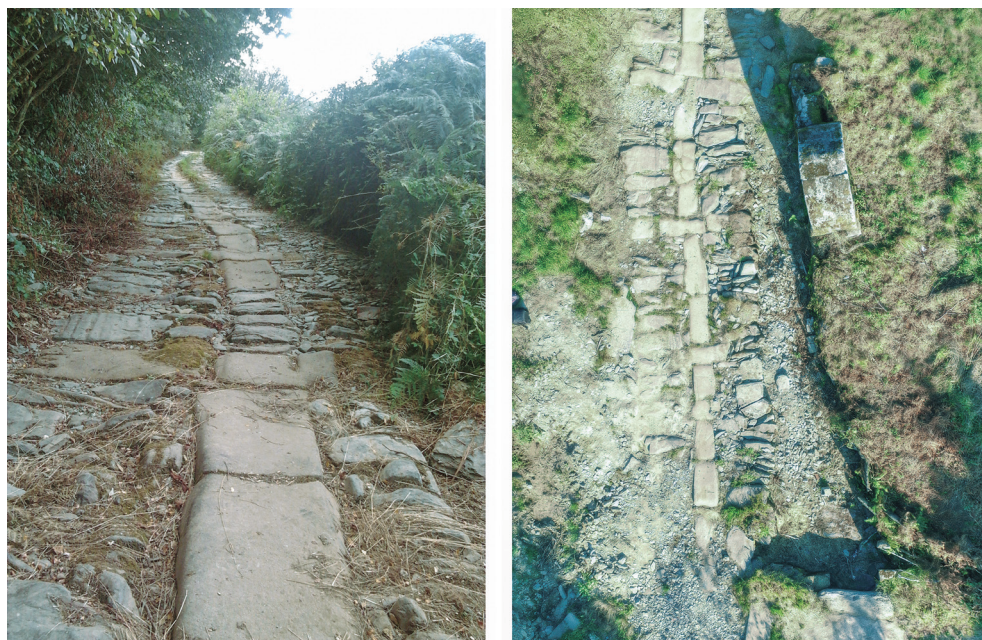
Figura 5 – Troço lajeado da Via do Marão junto ao Arco Memorial. Devido à ação das águas invernais do Ribeiro dos Azibais, desviado do seu curso natural para o caminho, esta calçada está muito degradada, necessitando de obras urgentes de consolidação e restauro.
