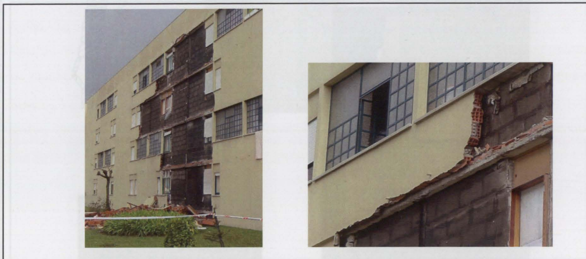
Figura 3.8 – Colapso de um pano de parede como consequência da instabilidade
