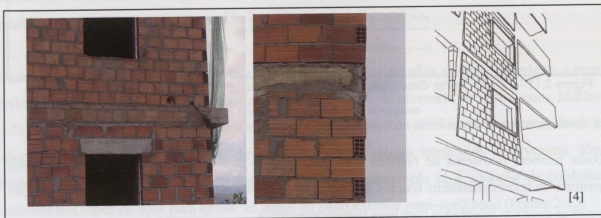
Figura 2.9 - Exemplos de correcções cerâmicas pelo exterior executadas à posteriori da execução do pano corrente
