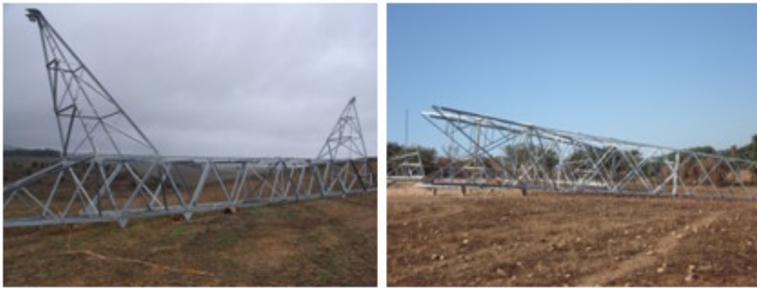
Figura 42 - Assemblagem de apoio metálico
