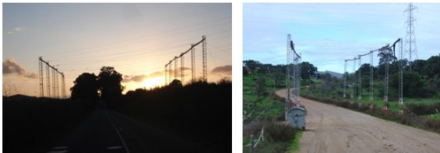
Figura 45 - Protecções utilizadas nas linhas aéreas
