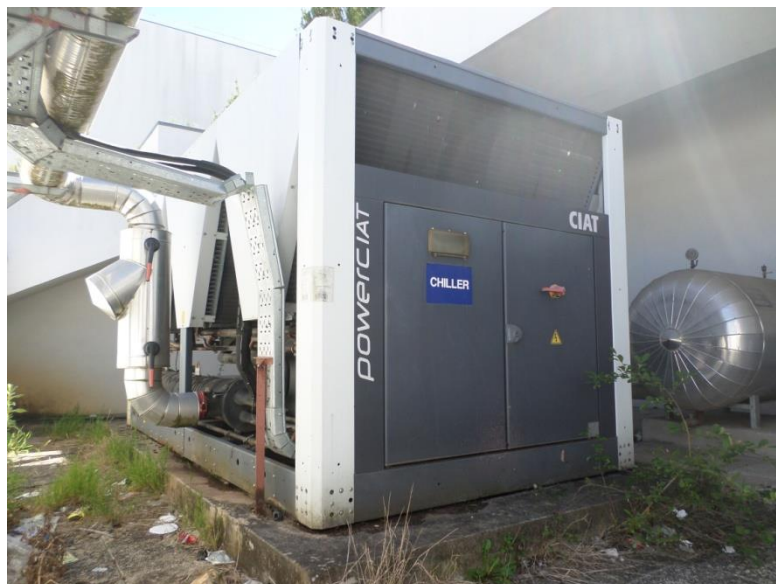
Figura 5-3 Chiller elétrico localizado na praça norte.
