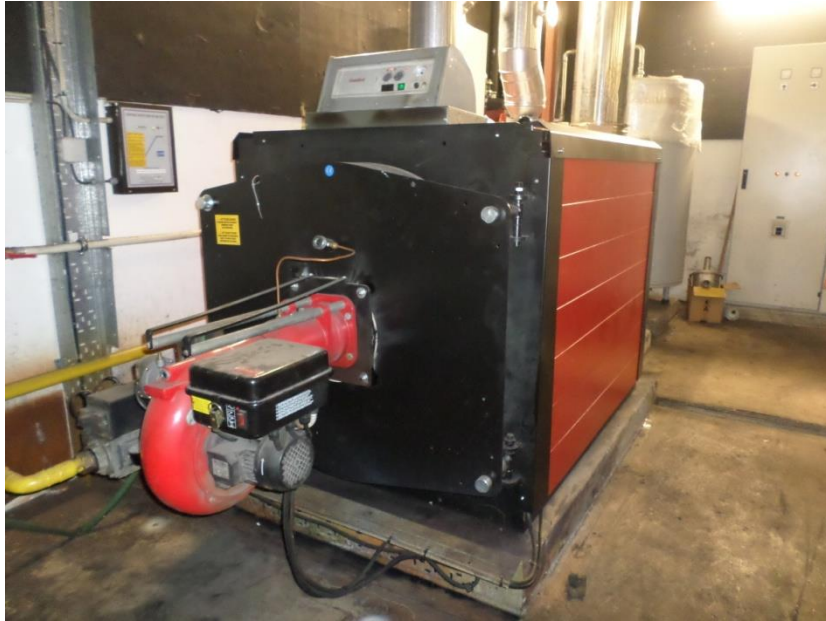
Figura 5-2 Caldeira e queimador instalados.
