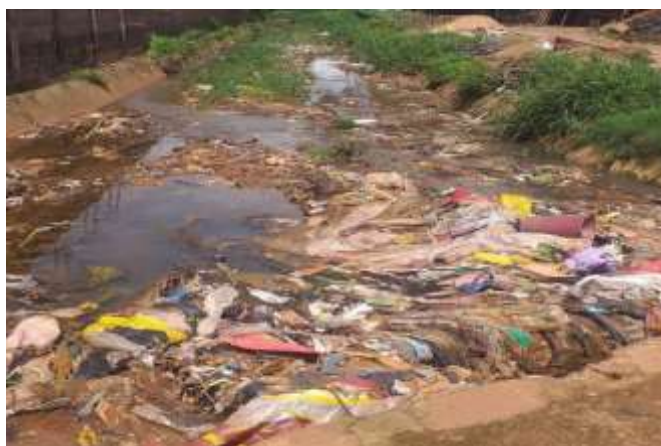
Figura 5: Canal de água fluvial obstruído com resíduos em Bairro Militar.
