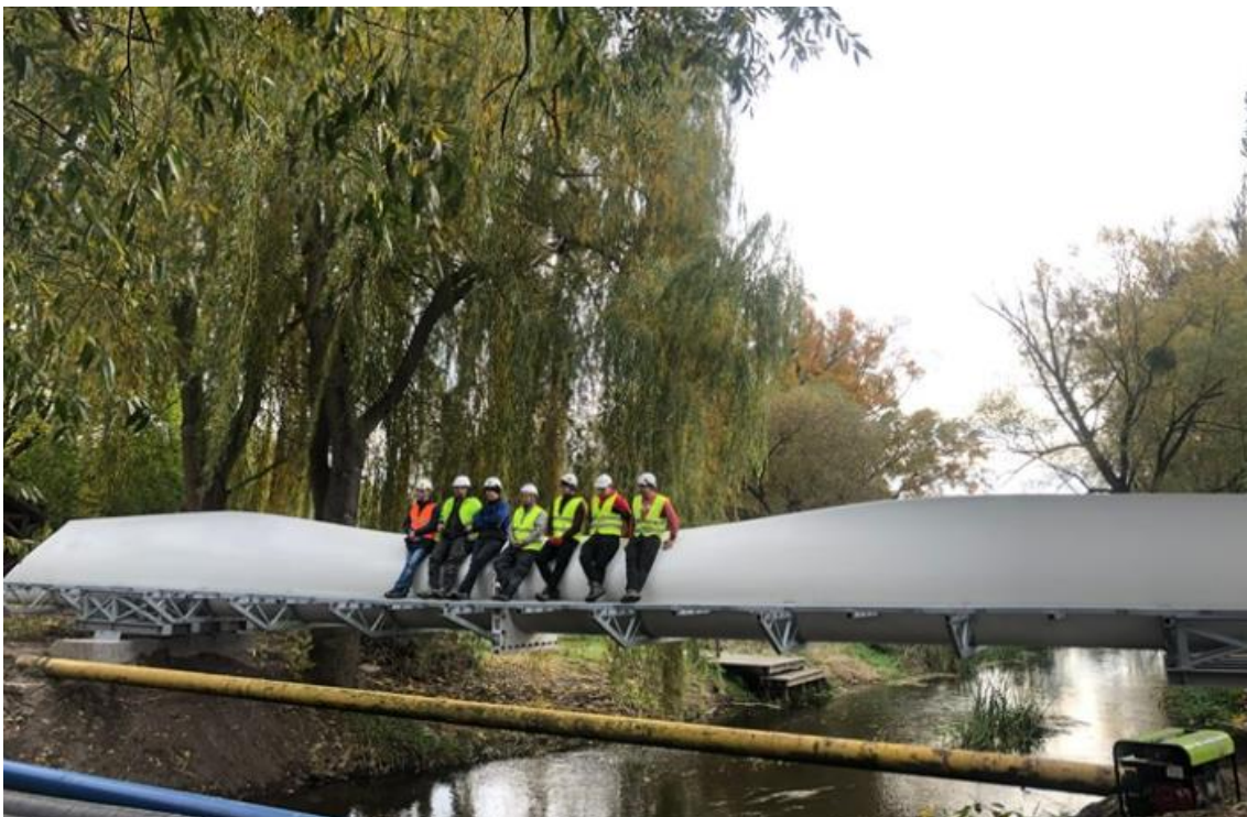
Ilustración 23: Pasarela en Szprotawa, Polonia (Fuente: Anmet).
