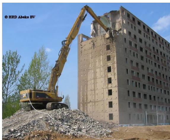
Figura 4.9 - Demolição indiferenciada de um edifício com recurso a equipamento de grande porte [4.15].
