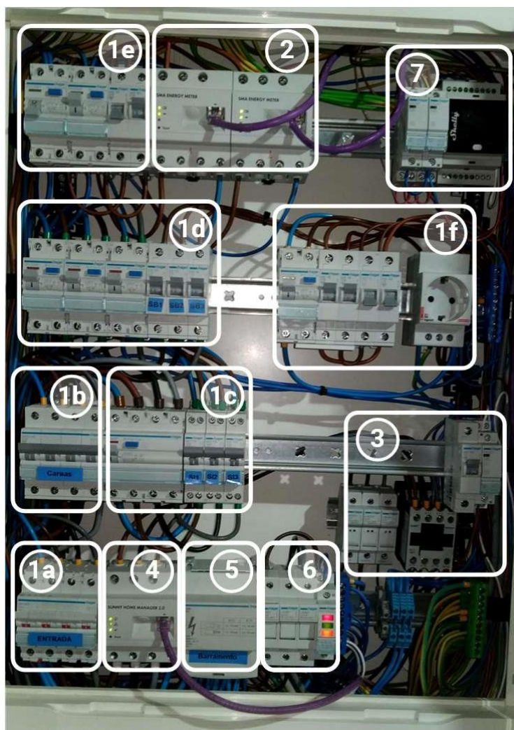
Figura 26: Quadro elétrico da microrrede inteligente da Casa da Seda atualmente Fonte: Autoria própria
