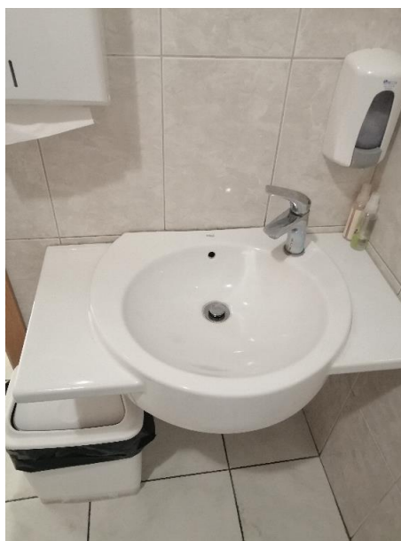
Figura 21 - Torneira de lavatório presente no pavilhão industrial
