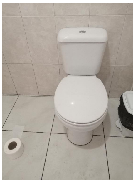
Figura 25 - Autoclismo presente no pavilhão industrial
