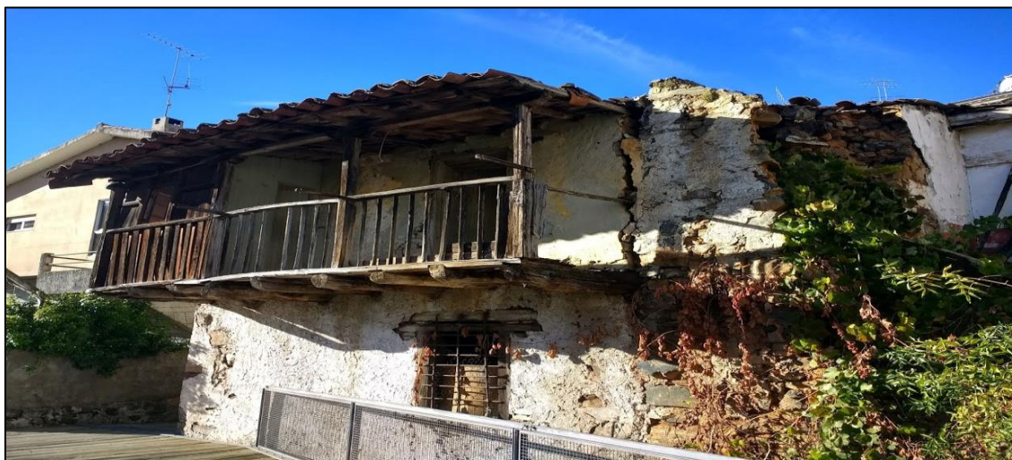
Figura 02. Construção típica com diversas patologias resultantes da ação do tempo, em Bragança Fonte: Arquivo próprio, 2018
