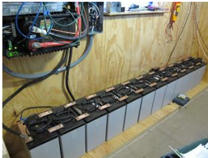
Figura 9: Banco de baterias utilizado numa aplicação solar. [8]
