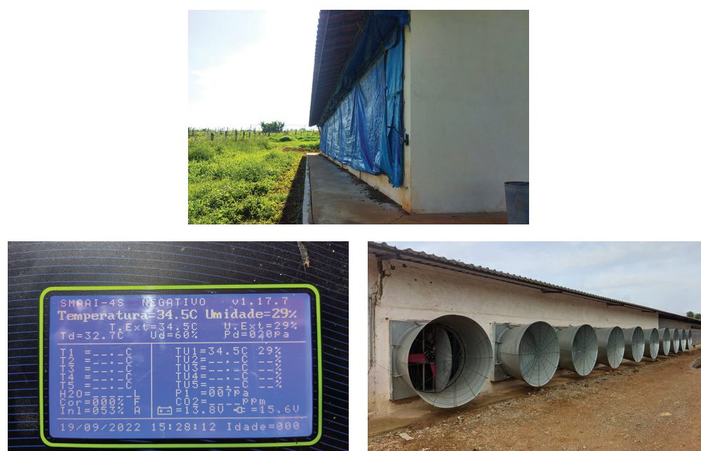
FIGURA 3.14 – (a) Condicionamento térmico natural com cortinas laterais; (b) sistema climatizado com (c) exaustores instalados numa das extremidades de um pavilhão parafrangos de carne com sistemas de ventilação negativa longitudinal.
