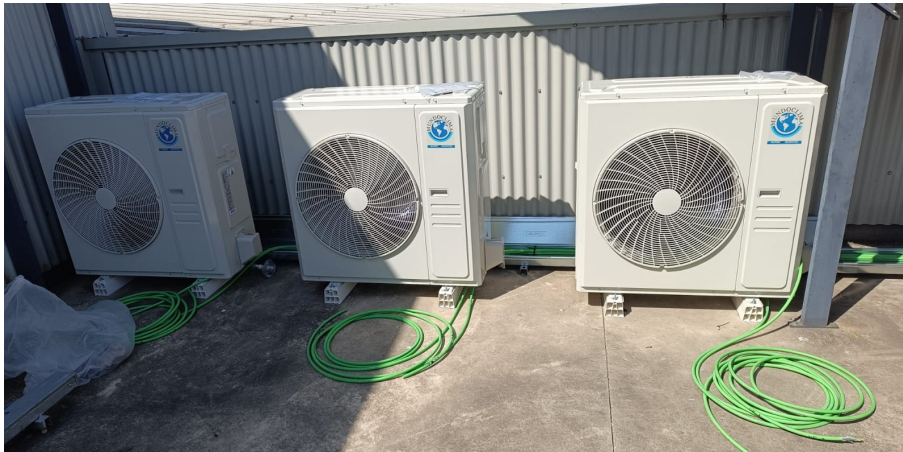
Figura 4.13: Unidades exteriores de climatização [Autoria própria].
