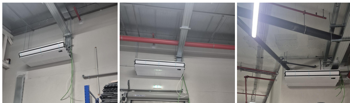
Figura 4.12: Unidades interiores de climatização [Autoria própria].
