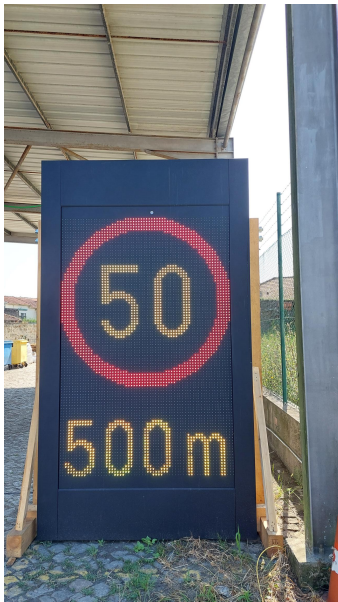
Figura 5.7: Sinalização de limite de velocidade
