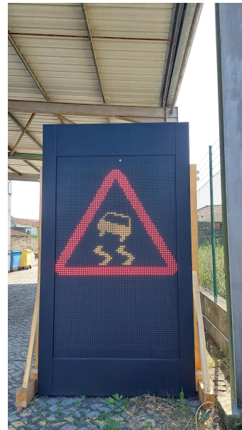
Figura 5.8: Sinalização de perigo de pavimento escorregadio
