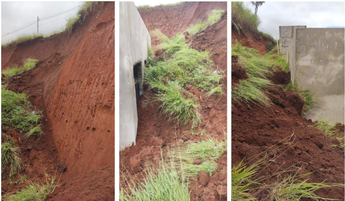
Figura 11 – Movimento de massa do talude no ano de 2022.
