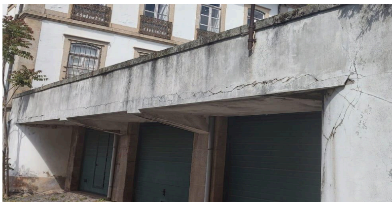
Ilustração 4 – Falhas de fissuras e manifestações de umidade
