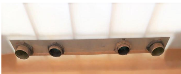
Fig. 3-10 – Reservatório superior: fixação interna dos tubos de descarga
