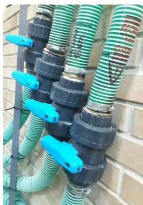
Fig. 4-5 – Válvulas das linhas de descarga
