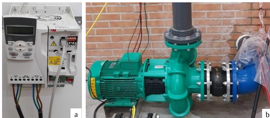
Fig. 4-4 – Sistema de bombagem a) inversor de controlo; b) motor e bomba centrífuga.
