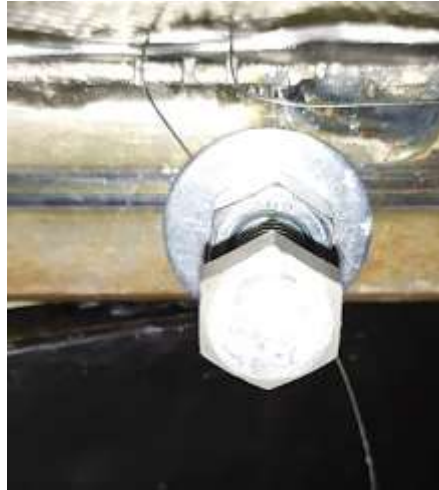
Figura 21: Fio sendo preso com o auxílio de um parafuso, uma porca e anilha/arruela
