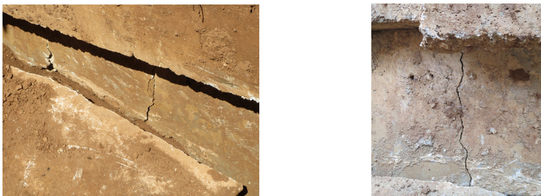
Figura 4 – Fendilhação vertical no tardo do muro, nas zonas próximas de ligação das ancoragens 1 e 3.
