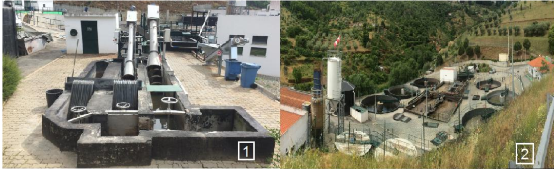
Figura 6 - [1] Entrada Efluente Bruto da ETAR. [2] Vista panorâmica da ETAR.
