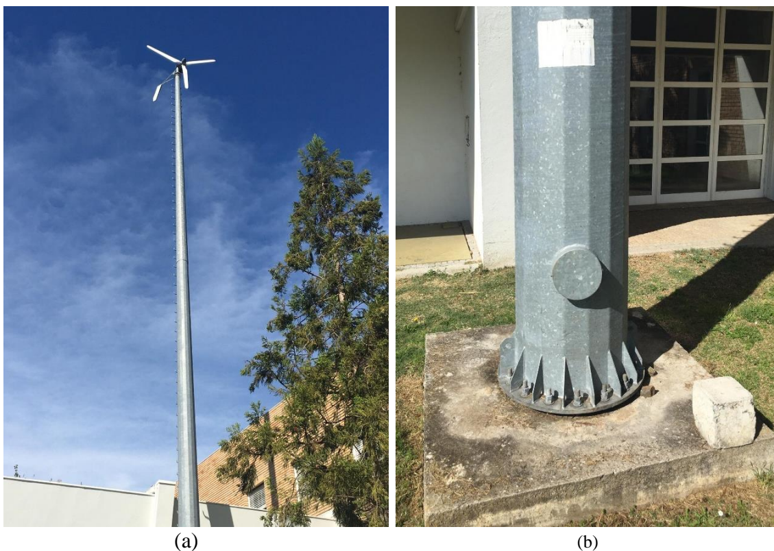
Figura 32: Torre Eólica do tipo HAWT do Campus do IPB - (a) Aerogerador e parte da torre, (b) parte inferior da torre
