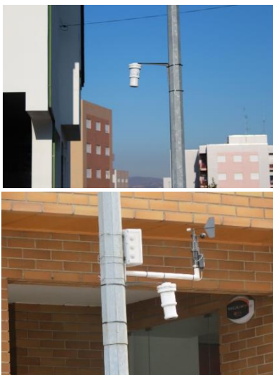
Figura 7 - Sensores de temperatura, humidade, velocidade e direção do vento
