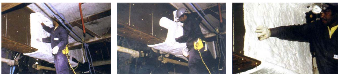
Figura 3.20 – Vista geral e detalhes da fixação da manta em fibra cerâmica num perfil soldado, por meio de pinos.
