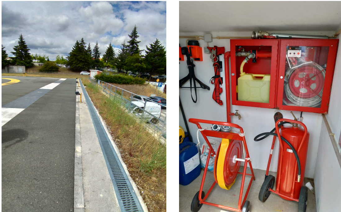
Figura 2.39: a) Sistema de drenagem do Heliporto de Bragança e b) Sistema de combate a incêndio.
