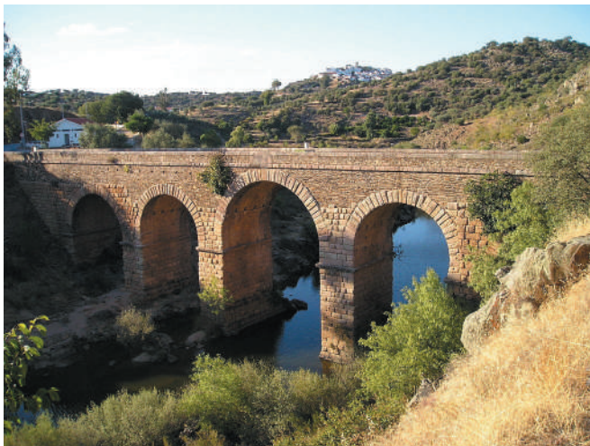
Fig. 5 – Estado actual da reconstruída ponte de Segura, sobre o rio Erges (foto: Durán Fuentes).
