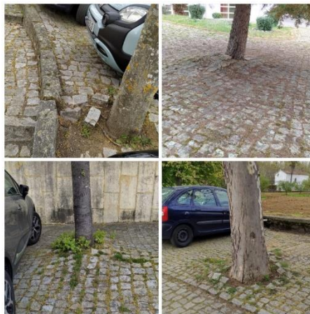
Figura 6: Árvores em conflito com calçamentos. (Fonte: o autor).
