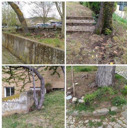
Figura 7: Árvores em conflito com muros e edificações. (Fonte: o autor).
