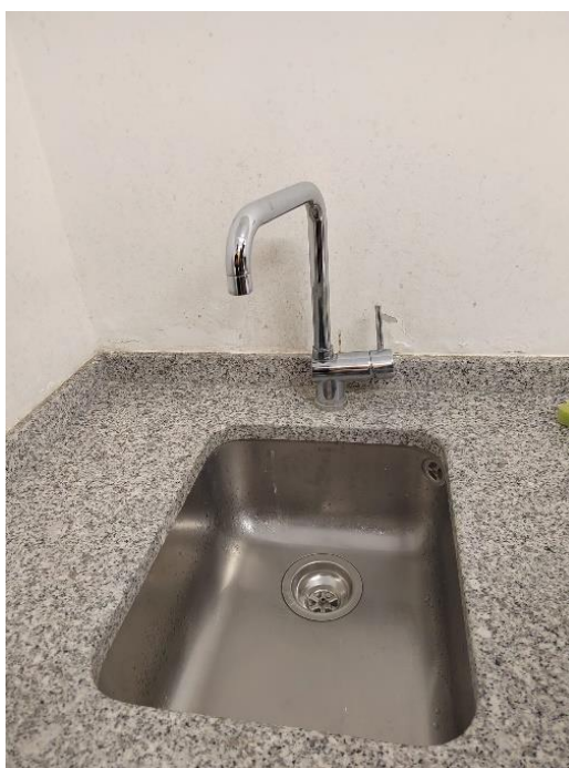
Figura 28: Torneira misturadora da lavanderia - Domus II.
