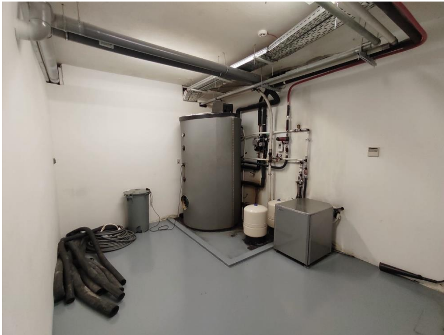
Figura 29: Sistema de aquecimento - Domus II.
