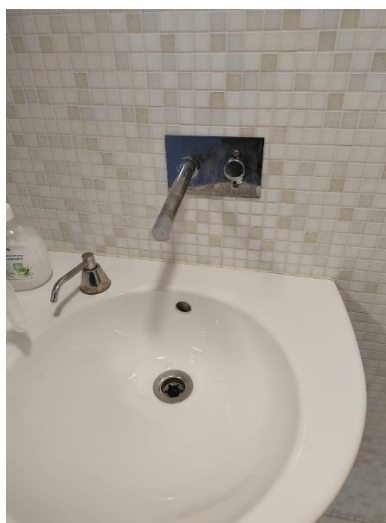
Figura 12: Torneira de lavatório temporizada - Domus I.
