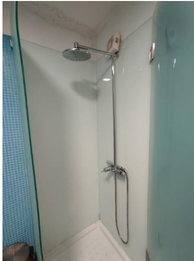
Figura 14: Chuveiro e mangueira do chuveiro - Domus I.
