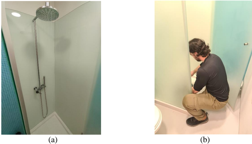
Figura 24: Chuveiro e mangueira do chuveiro - Domus II (a); Medição do caudal do chuveiro e da mangueira do chuveiro - Domus II (b).
