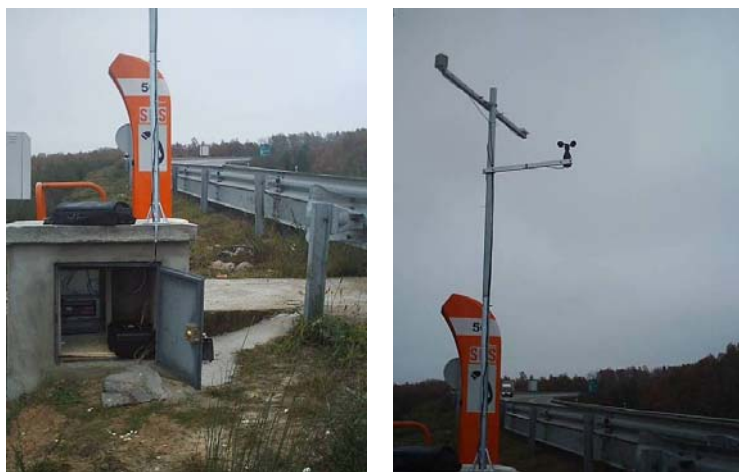
Figura 6.14 – Cabine com equipamento de aquisição de dados e mastro meteorológico
