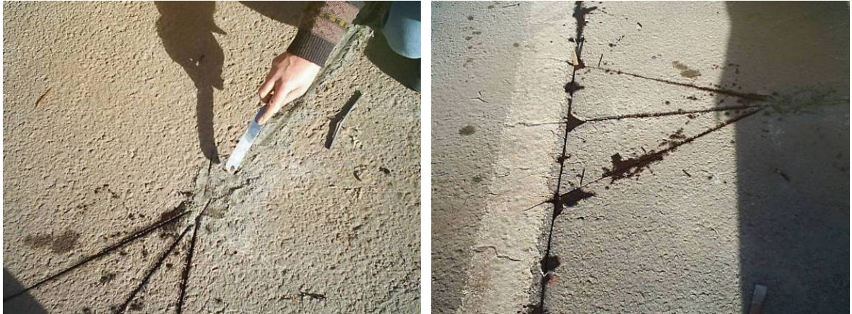
Figura 6.12 – Colocação de termopares no pavimento – aspecto dos rasgos após enchimento com betume
